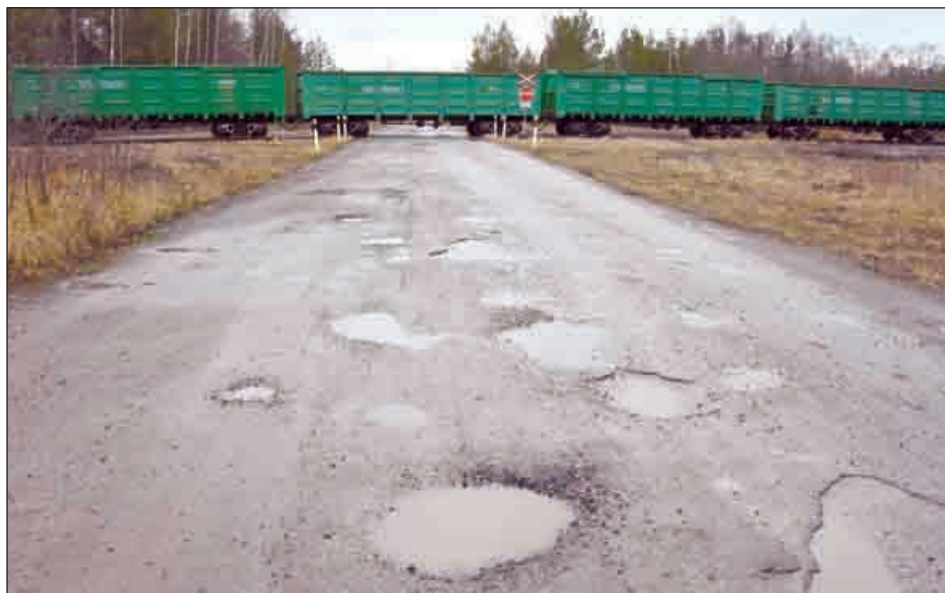
Нужен ямочный ремонт.
