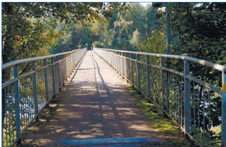
Мост через реку Сытке давно требует ремонта.
