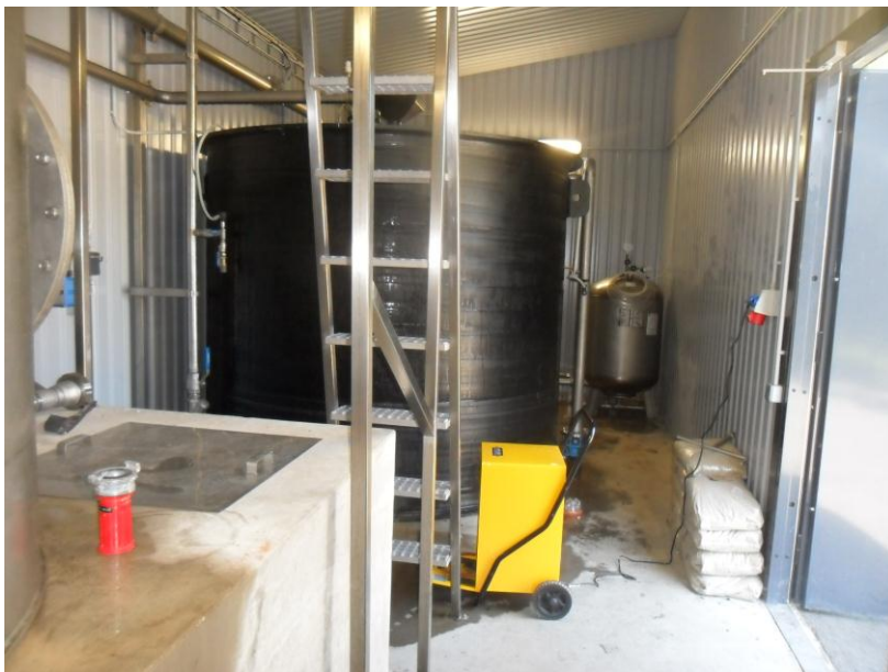
Joonis 6-8 puhtaveereservuaar, 9 m 3 (esiplaanil õhukuivati, tagapool nähtav hüdrofoor, 500 l)
