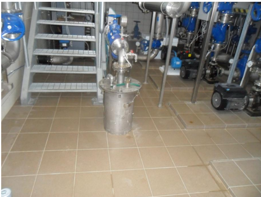
Joonis 6-17 Pk-12 päis paikneb II-astme ja VTJ ühes pumplakompleksis
