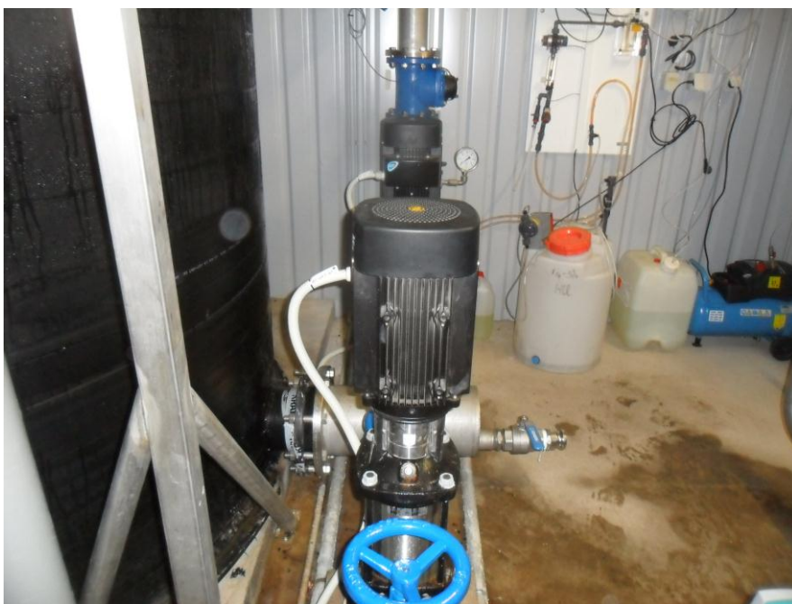
Joonis 6-9 II-astme pump, tagapool uhtepump ja seina ääres NaOCl seade
