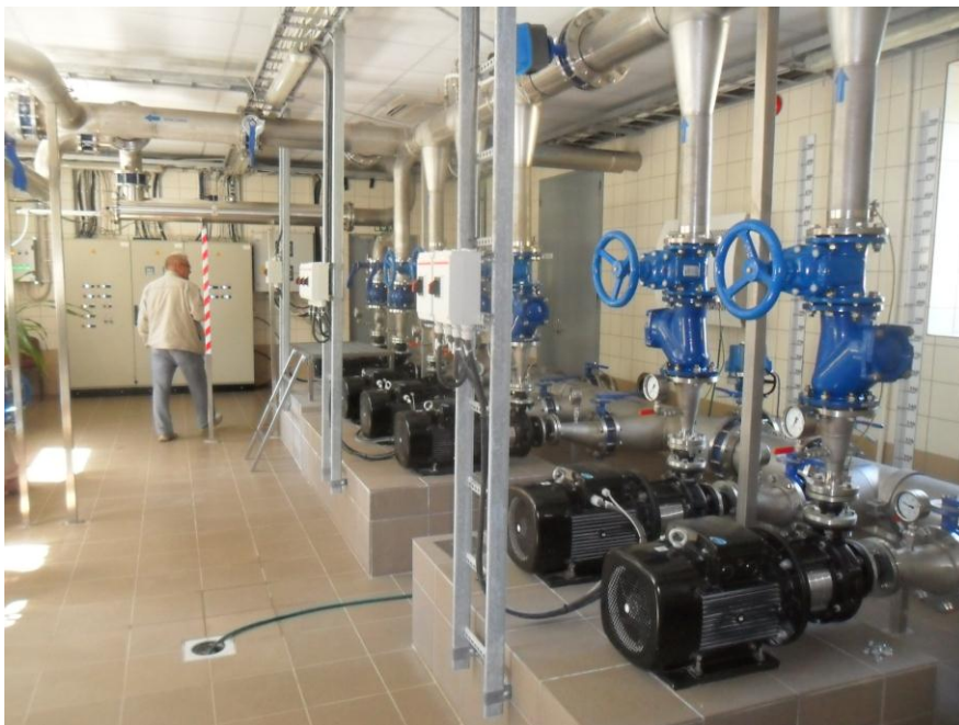
Joonis 6-12 Keskpumpla II astme pumpla sisevaade (näha on kõik viis pumpa)
